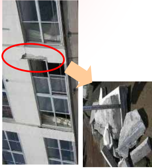
老朽化により モルタルが落下
