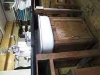
度重なる配管の破損
